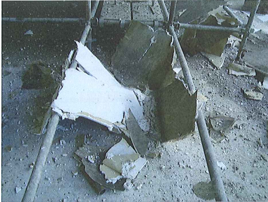
Img 10: Estado do teto existente
